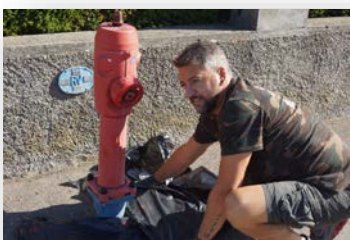
Peintures des bouches à incendie
